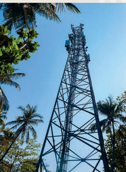
3.300 Mobilfunktürme verbinden Millionen von Menschen in Myanmar.
